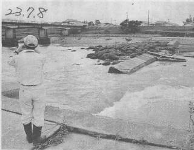
一部流失した川内川の床固め堰堤（写真左が加久藤橋）17日午後、えびの市小田
